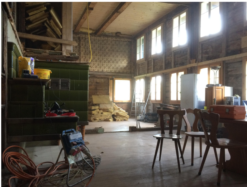
Abb.2 Wohnzimmer während Umbau mit fehlender Decke
